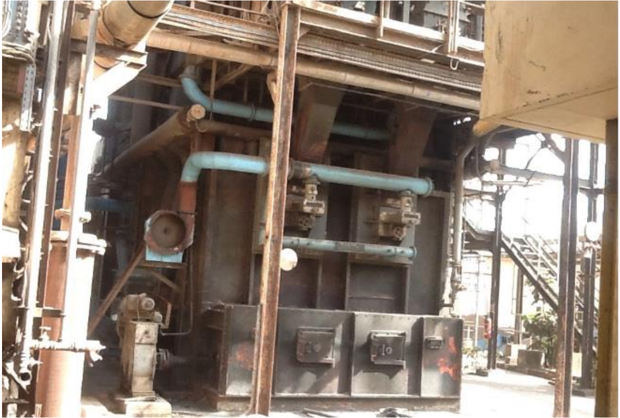
Figure 3.2 : Photo de la chaudière Duquenne
