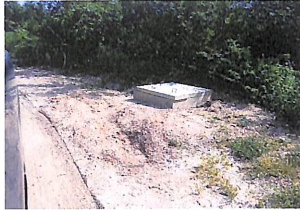
Réseau AEP sur l'emprise
