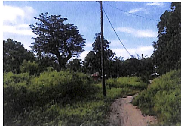
Réseau électrique MT sur l'emprise
