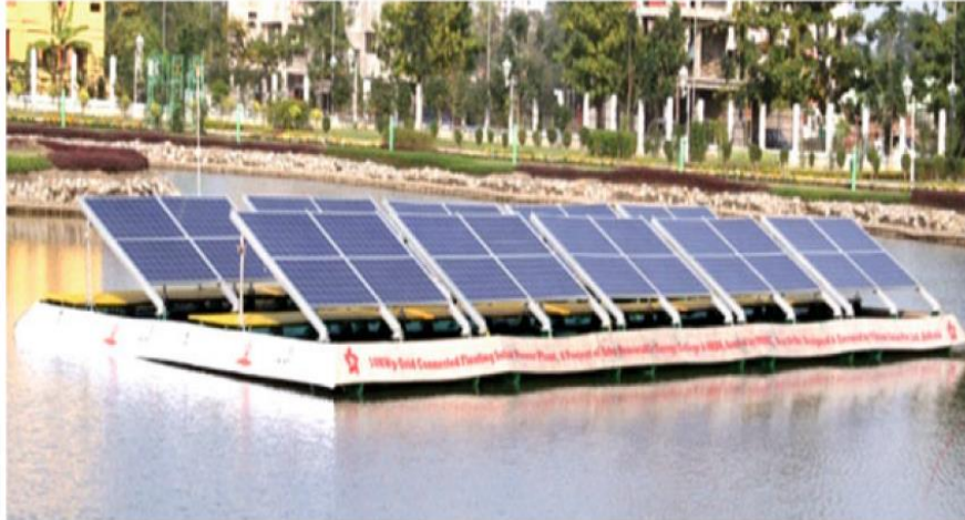
Figure (I-21) : Système photovoltaïque flottant (SPVF) de 10 kW [26]
