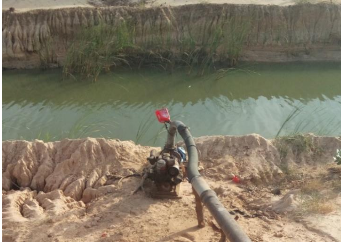
GMP installé sur le chenal de SENEGINDIA
