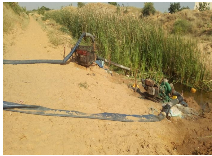
GMP installé sur le Chenal de VITAL
