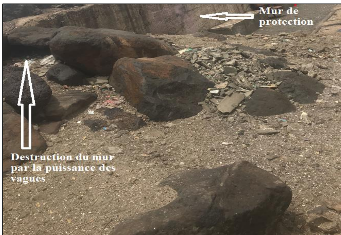
Photographie 5 : Mur de protection sur le littoral de Rufisque (Faye, septembre 2022)
