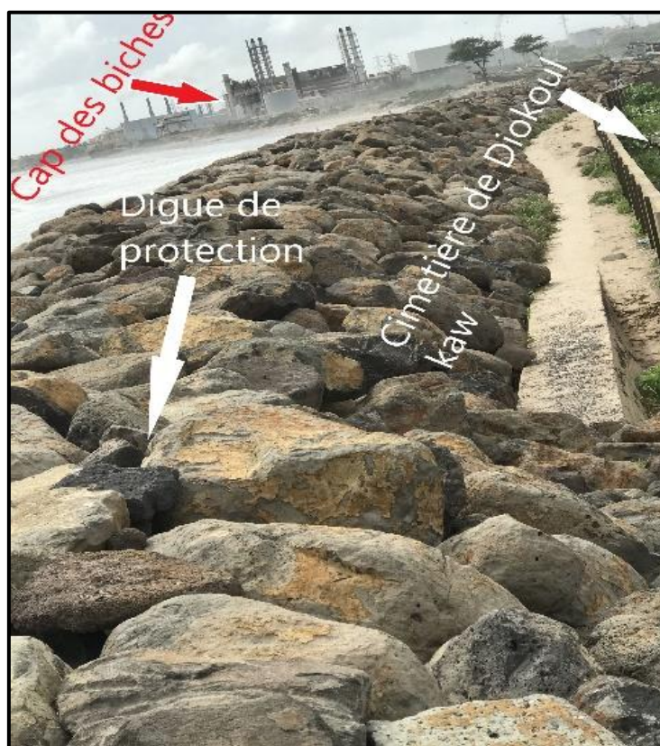
Photographie 8 : Digue de protection des cimetières (Faye, septembre 2022)
