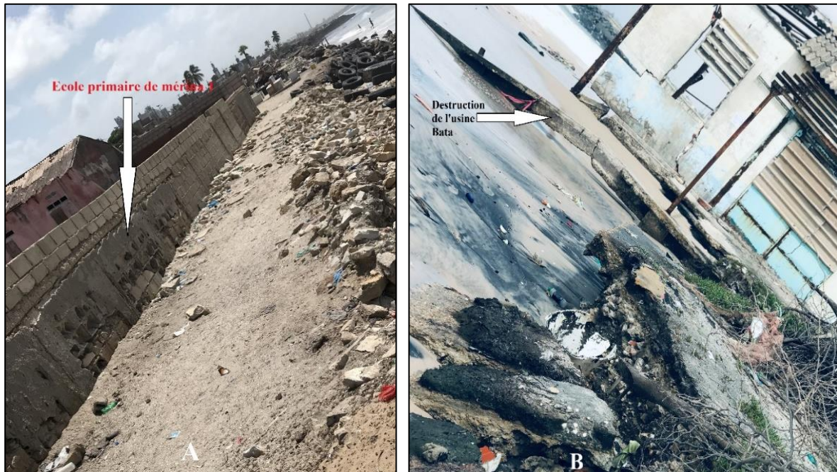
Photographie 12 : Effets de l'érosion sur l'école primaire de Mérina 1 et de l'usine Bata (Source : Faye, septembre 2022).
