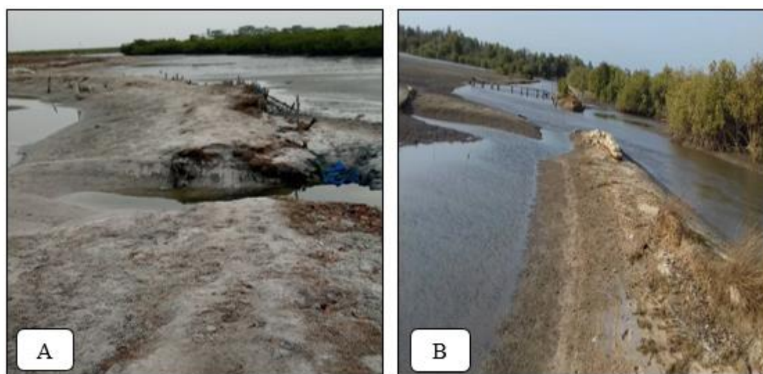
Photo 17: Digues de protection dégradées à Niomoune (A) et à Diogué (B) (Source : Sané, Avril 2021)
