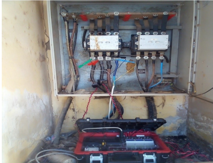
Figure 2. 3 : Une mallette d'intelligence visualisée et branchée au niveau du coffret général ou la boîte de départ SENELEC.
