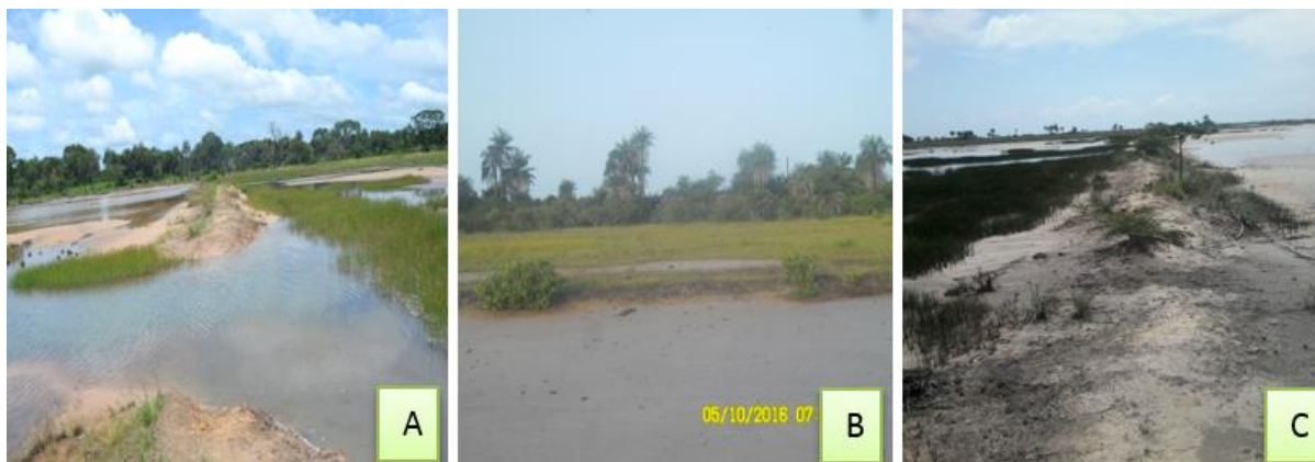
Photo 22: Digues dégradées à Colomba (A), Saloulou (B) et Hitou (C) (Photo Soumaré, 2016)
