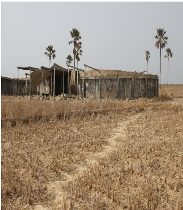
Photo 16: Ancien bassin de stockage d'eau de pluie dégradé (Cliché: A. Sagna 2018)
