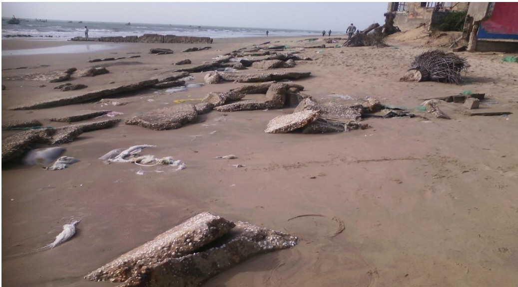
Photo 26: Destruction du mur et de l'ouvrage de protection épi du campement la nature (BOCOUM, Avril 2016)
