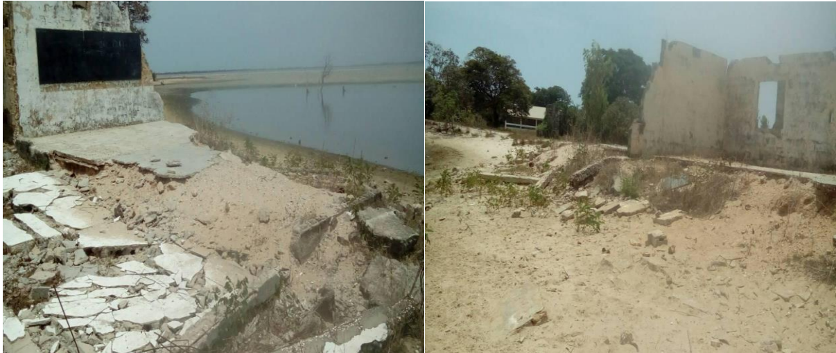
Photo 15 : Bâtiment de l'école primaire de Diogué détruit par l'érosion côtière (BOCOUM, Juin 2017)
