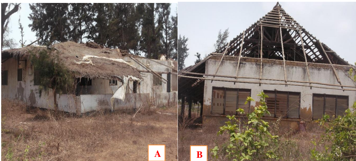
Photo 5 : Dégradation des bâtiments de l'hôtel Karone à Kafountine (BOCOUM, Juin 2017)
