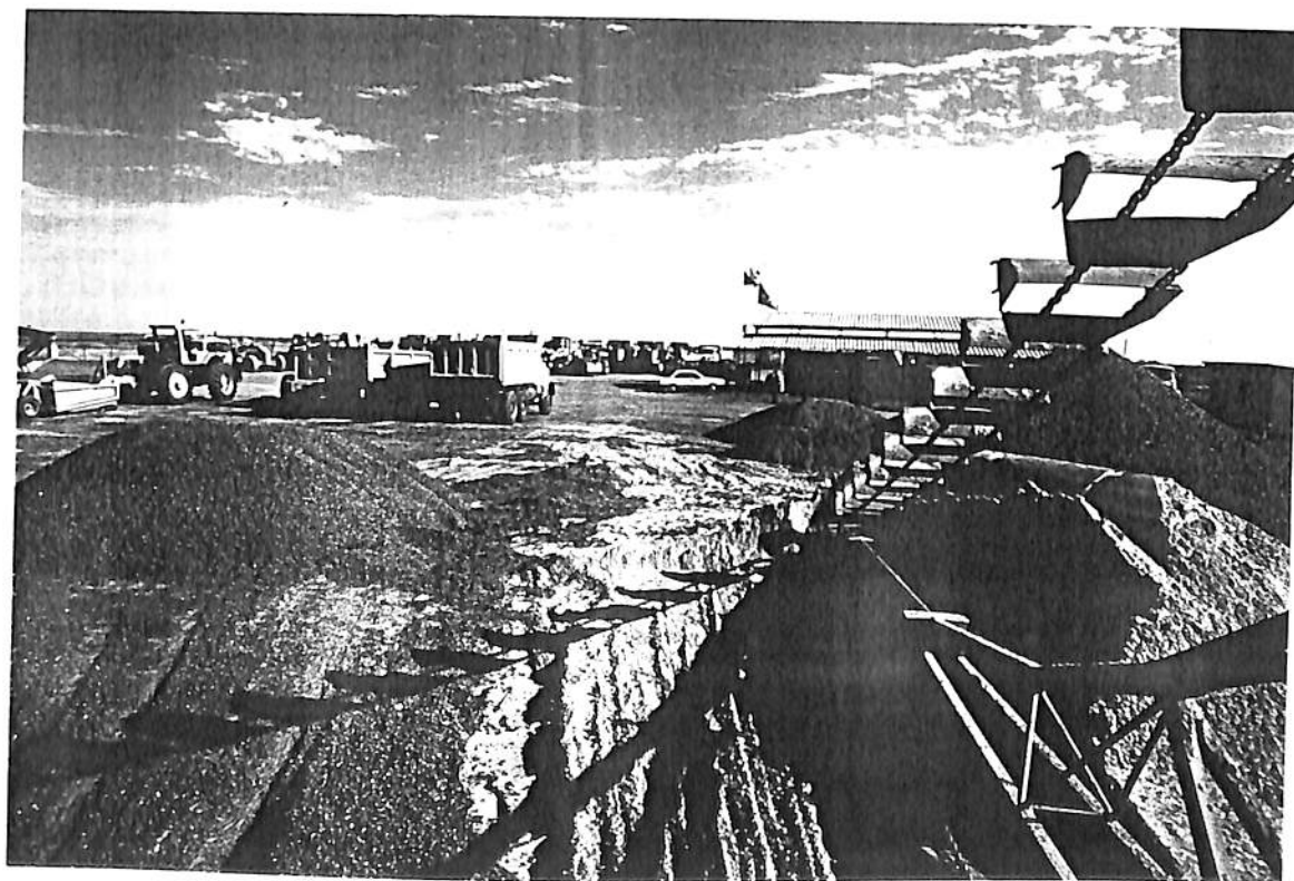
Rayon raclant (centrale ELBA)
