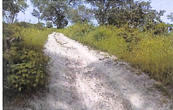
Erosion sur l'axe de la piste
