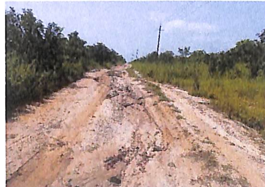
Erosion de l'axe de route
