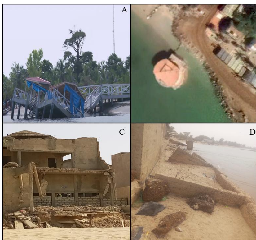
Planche photographique 8: Destrutions d’infrastructures : (A : Pont de Dionewar, image Dmedia 2018 ; B : Case des tous petits à Saly Niakh Niakhal, image google earth 2020 ; C : Hôtel à Saly Portudal, Yade 2022 ; D : Quai de pêche Pointe Sarène, Yade, 2025)
