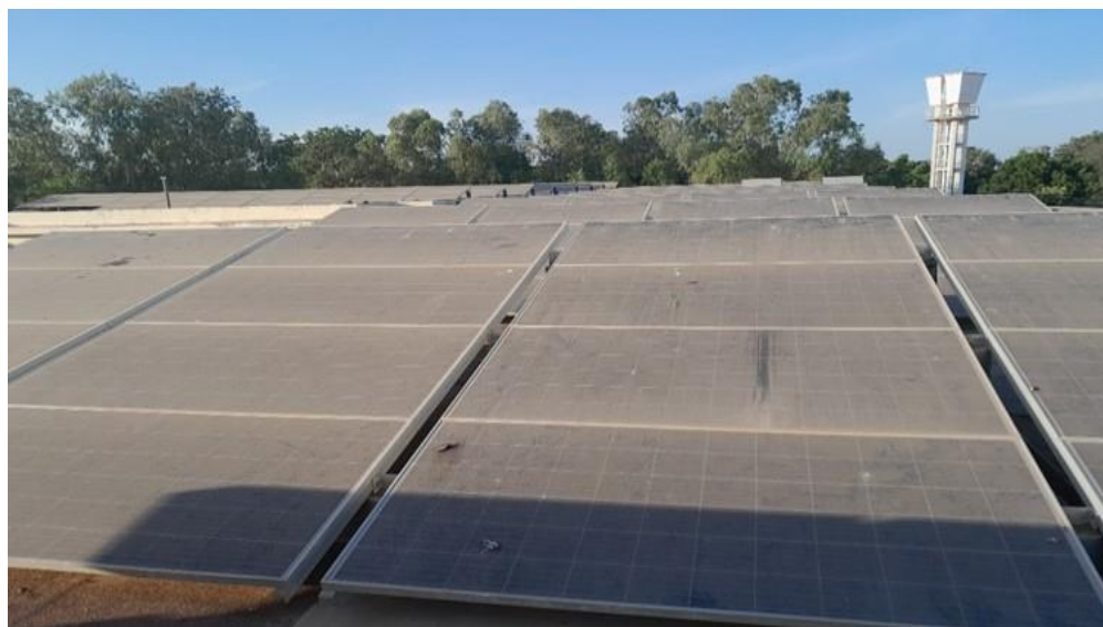
Figure 8 : Photo de la minicentrale solaire de l'hôpital de Thiès
