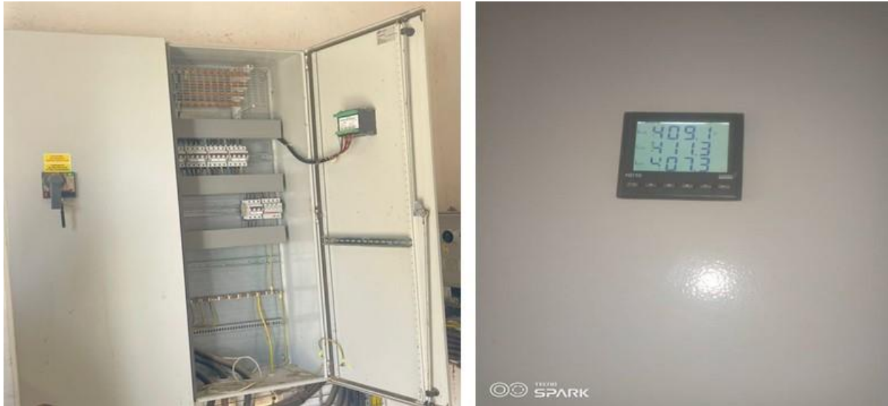
Figure 12 : Photo du coffret de raccordement électrique
