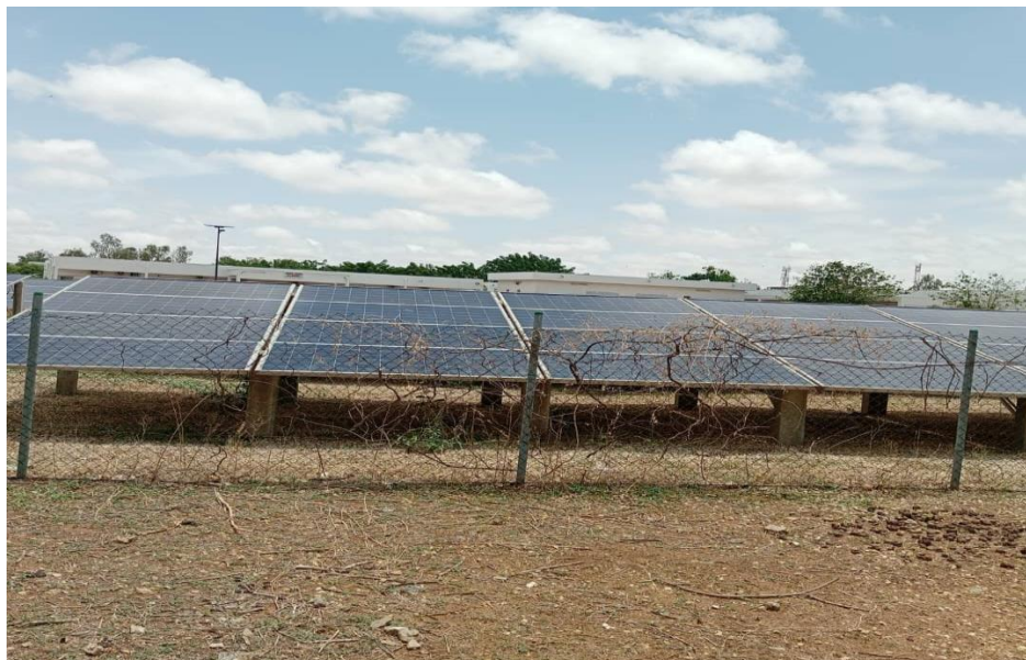
Figure 10 : Photo de la minicentrale solaire de l'hôpital de Diourbel
