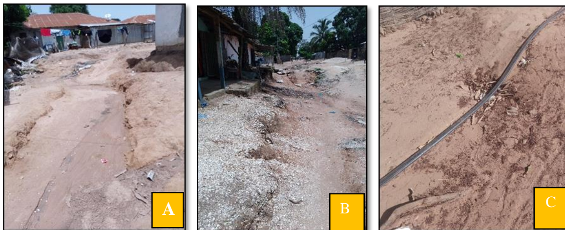
Photo 21: (A) Des maisons menacées par l'érosion hydrique ; (B) Une route dégradée par l'érosion ; (C) Un tuyau d'assainissement déterré par l'érosion à Abéné (février 2023)
