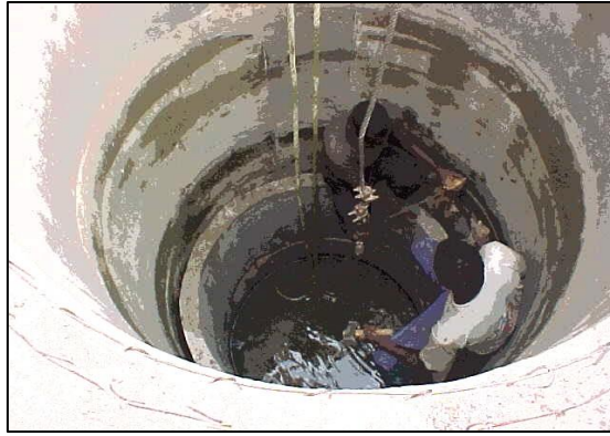
Photographie 8 : Fonçage d'un puit à Sinthiang Chérif par le GCV ( Source : SADIO, 2018)
