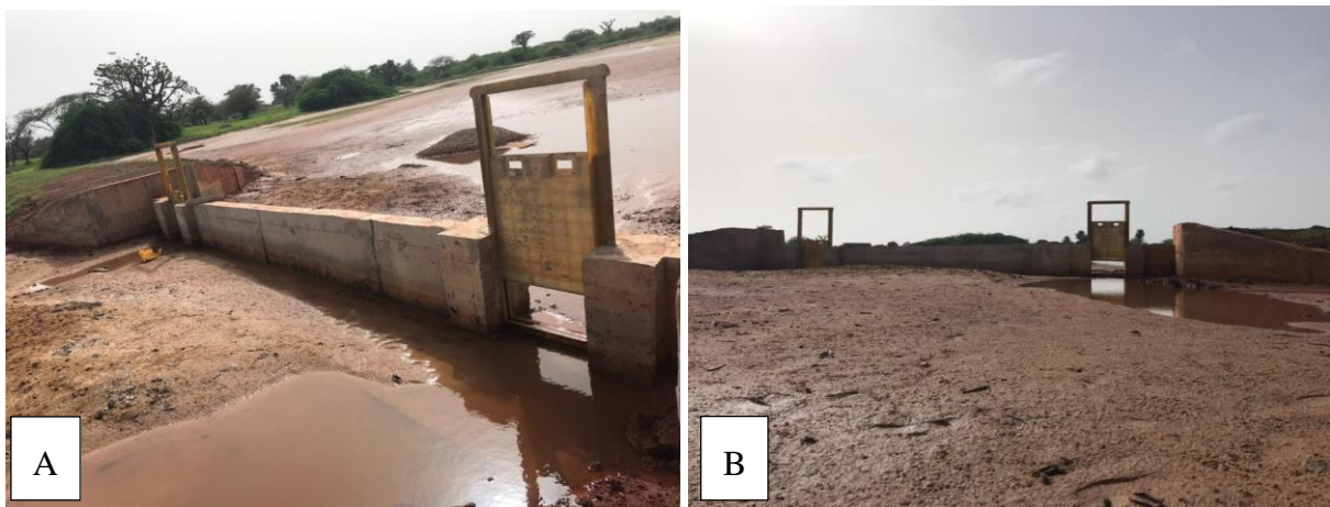
Photo 17 : Digue antisel réalisée par APIL à Ngallou (A) et à Guedj (B) ( Diouf, août 2022 )
