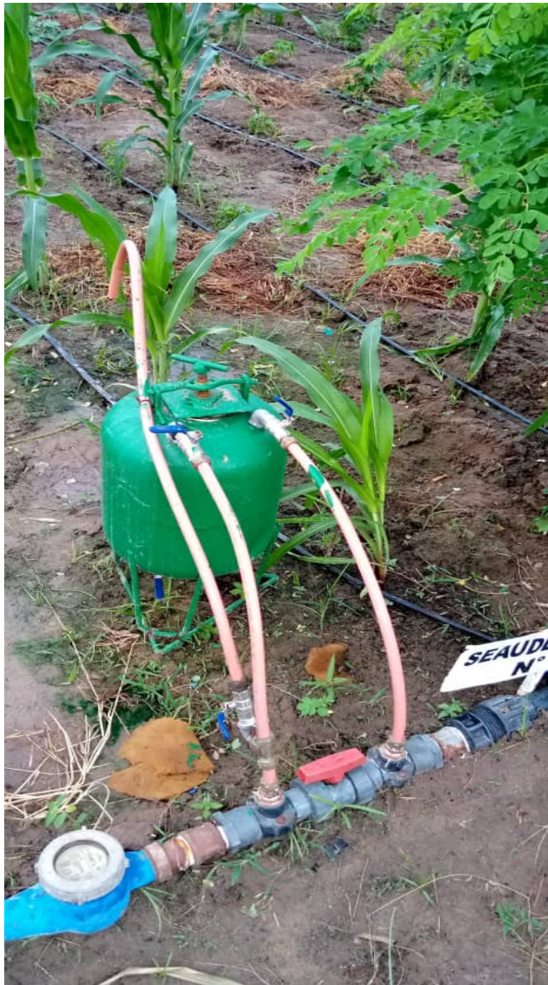
Compteur d'eau de parcelles
