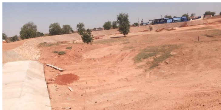
Photo 8 : Digue de protection aménagée à l'Est de la commune de Kaffrine.
