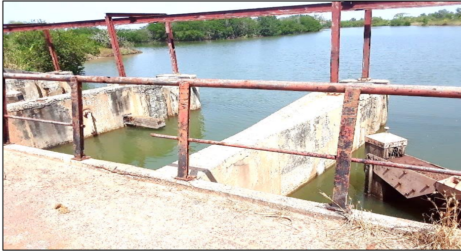
Photo 17 : Dégradation du matériel du barrage anti-sel de Guidel (Janvier 2022)
