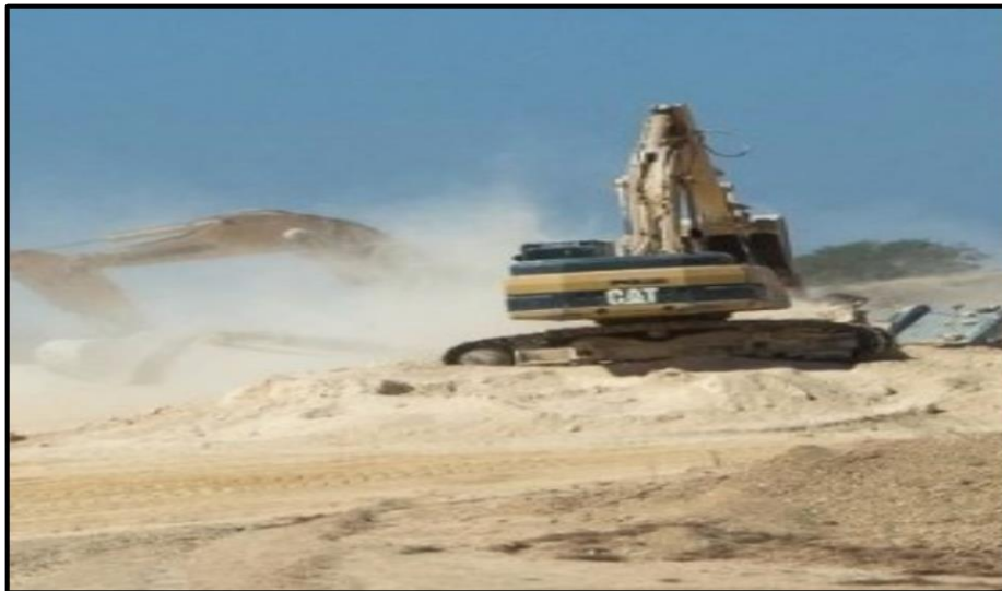
Photo 13 : Soulèvement de vagues de poussières par les pelles hydrauliques(Source : SEPHOS, 2018)
