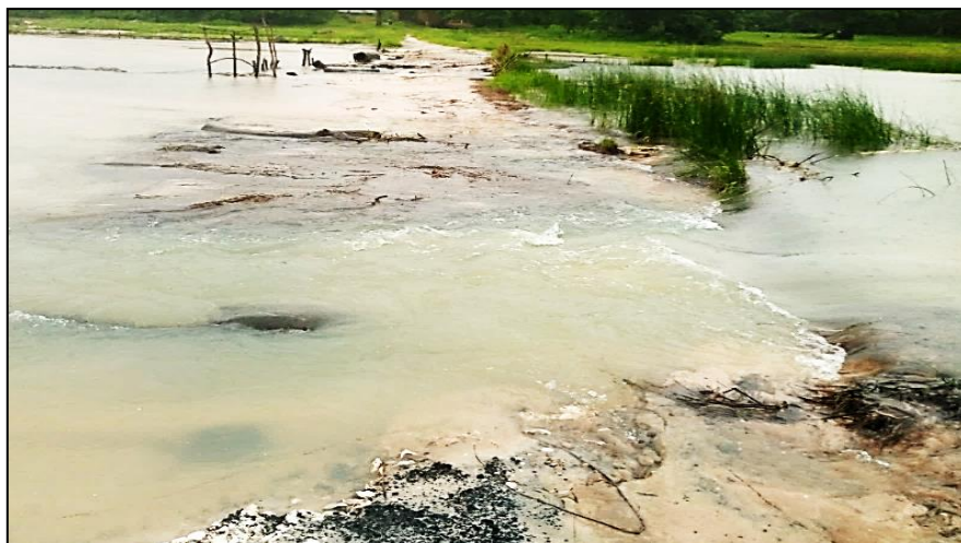
Photo 14 : Ruissellement d'eaux pluviales sur la route départementale 14.2.00 à Youtou (Source : Coly, septembre 2020)
