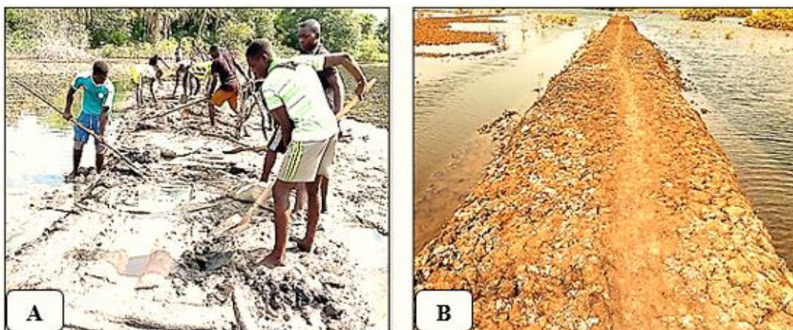
Photo 41 : Travaux de réhabilitation de la digue de désenclavement sur l'axe Effoc-Émaye (A) et digue réhabilitée sur l'axe Youtou-Kaguitte (B) (Source : Coly, juillet 2020)
