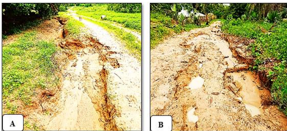
Photo 47 : Route départementale 14.2.00 dégradée par les eaux de ruissellement à Effoc (A) et à Youtou (B) (Source : Coly, août 2020)
