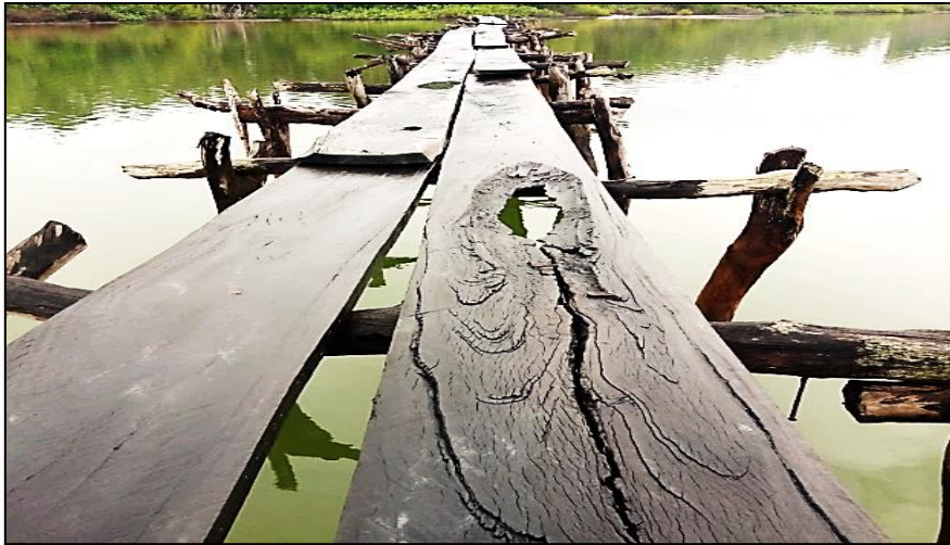
Photo 44 : Pont traditionnel en état de fissuration (Source : Coly, juillet 2020)
