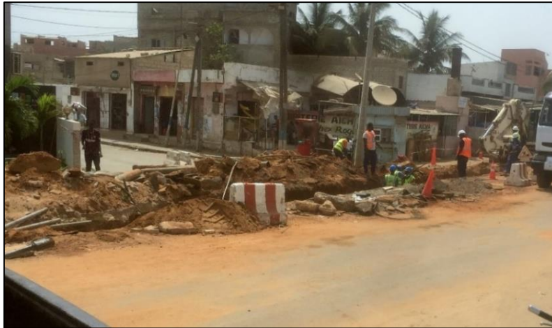
Photo 16 : Route barrée par les agents de la SEN'EAU lors des travaux portant sur le réseau d'adduction d'eau (DIOP M, juillet 2021)
