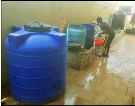
Photo 10 : Dispositif d'AEP au premier étage du centre commercial DIOR de l'unité 20 (DIOP M, juillet 2021)
