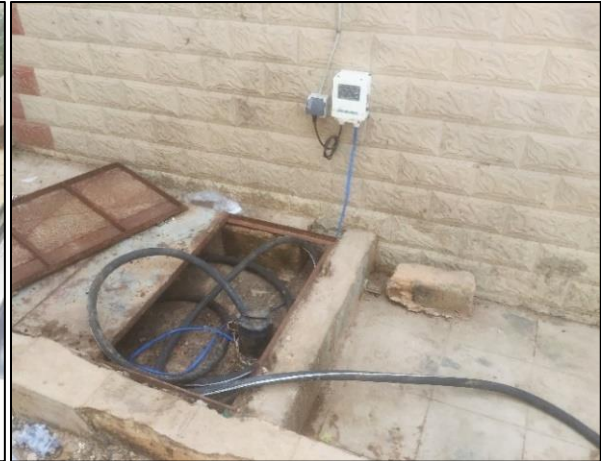
Photo 5 : Pompe électrique située à l'unité 19 de la CPA (DIOP M, juillet 2021)
