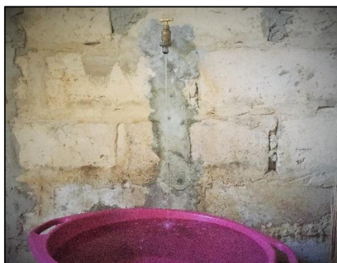
Eau de robinet coulant avec une très faible pression dans une concession à l'unité 23 de la CPA (DIOP M, Juillet 2021)
