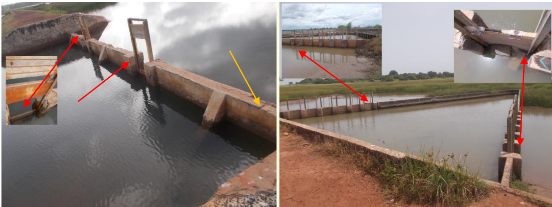
Photo 18 : Ouvrage de régulation du niveau de digue anti sel modernes en état de dégradation (mis en exergue par les flèches) : à droite : ouvrage en bec de canard à la confluence des vallées Birkama et Baconding, à gauche : ouvrage linéaire dans la vallée Djibanar (Clichés Mansaly, juillet 2017)
