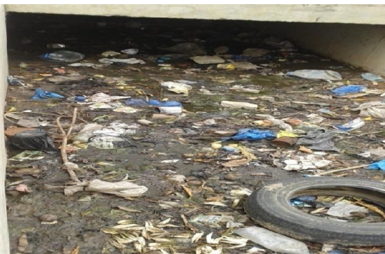
Photo 10 : Le caniveau de Lyndiane bouché par les ordures ménagères. (Gueye, 2015).
