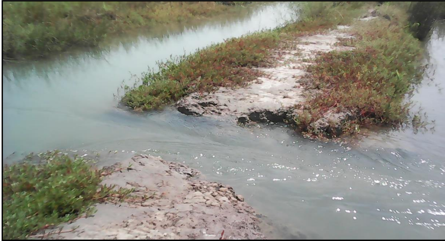
Photo 24: Rupture de la digue anti sel du village de Diagon. ( Source : Badiane, 2016 )
