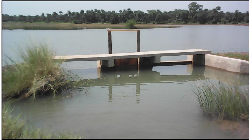
Photo 23: Ouvrage hydraulique construit par le CICR sur la digue anti sel de Diagon. (Source : Badiane, 2015 )
