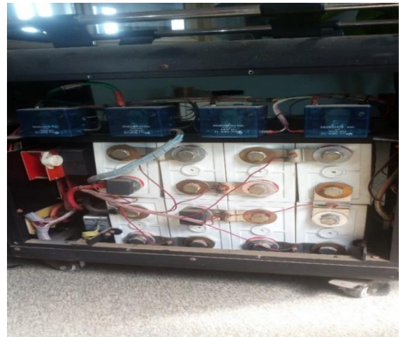
Figure 2.1-8 : Batteries de l'onduleur
