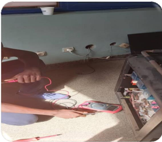
Figure 2.1-7 : Mesures de la tension des batteries de l'onduleur
