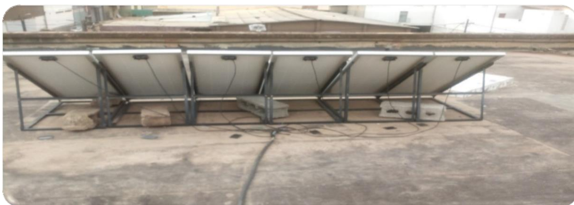
Figure 2.1-2 : Face arrière panneaux photovoltaïques installés à ENERGECO AFRIQUE
