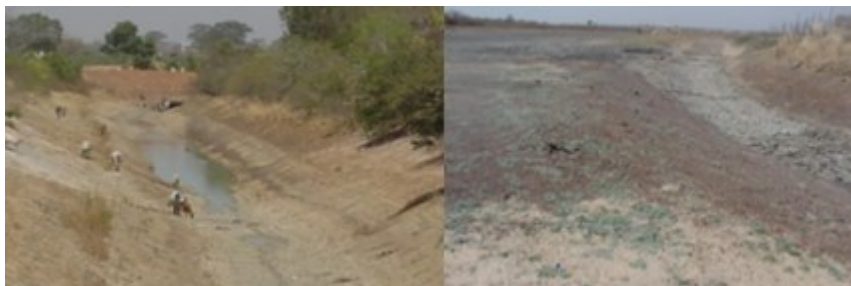
Photo 1 : Chenal d'amenée asséché et Rivière Anambé à sec (SODAGRI, 2003)
