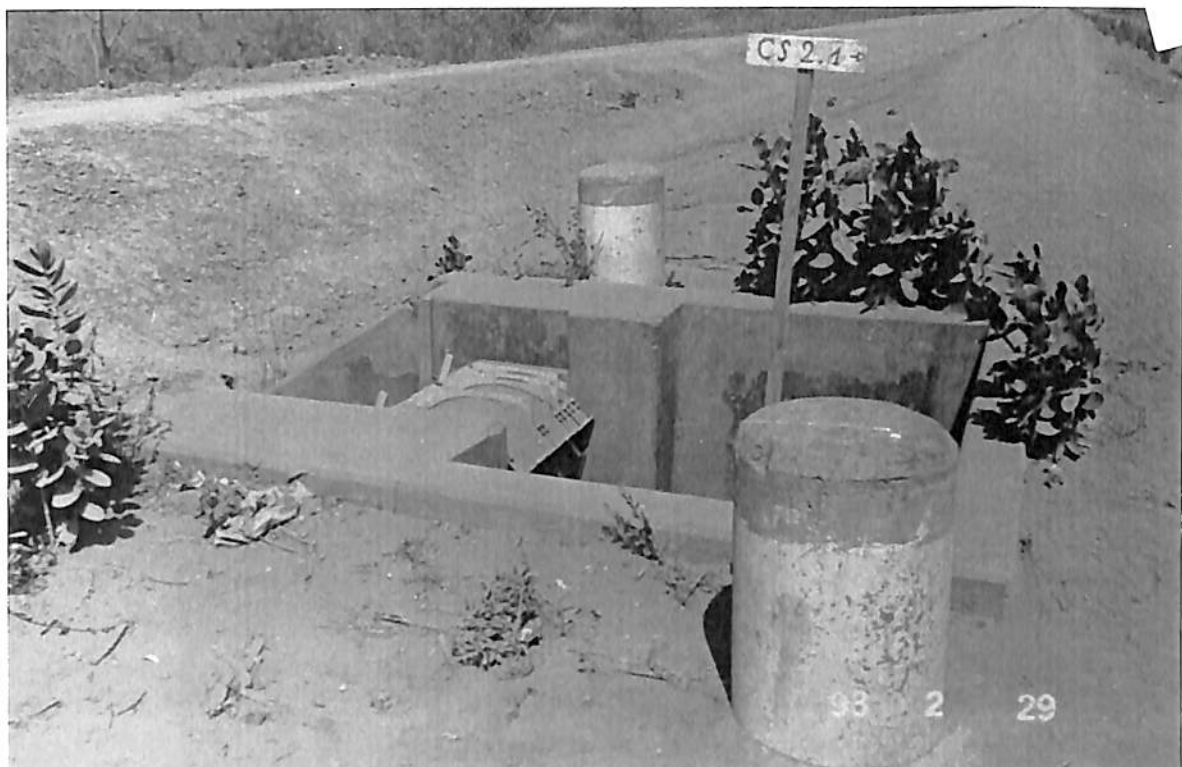
TRAVAUX EN COURS D'EXECUTION (ENTREPRENEUR RAZEL) PRISE SECONDAIRE ; REGLAGE DE DEBIT A L'AIDE D'UN MODULE A MASQUES (PRISE MODULEE)
