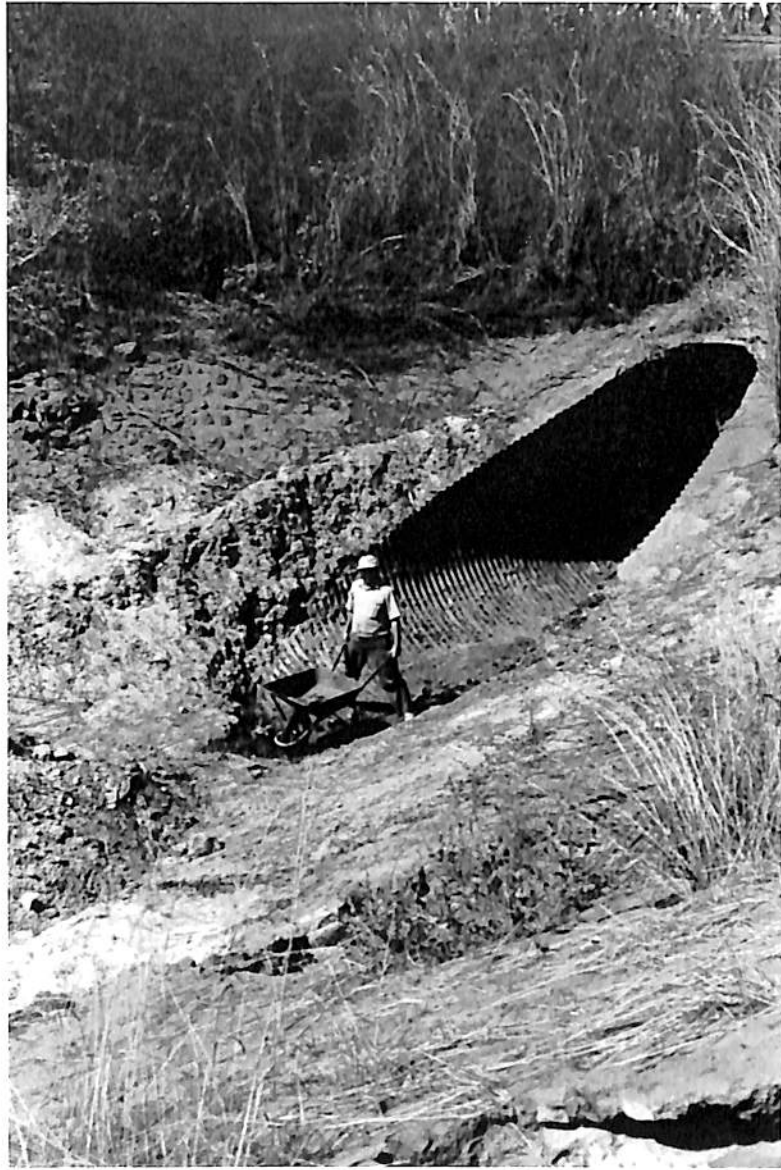
OUVRAGE DE FRANCHISSEMENT DANS LE CHENAL D'AMENEE RIVE DROITE VUE DE L'AMONT ; NOTONS LES AFFAISSEMENTS SUR LE PAREMENT DU TALUS EN PERRE MACONNE
