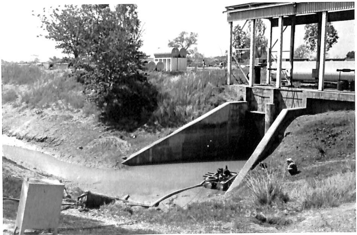
MEME COTE DE LA STATION DE POMPAGE, AVEC EGALEMENT UNE VUE PARTIELLE DU CHENAL D'AMENEE ;
