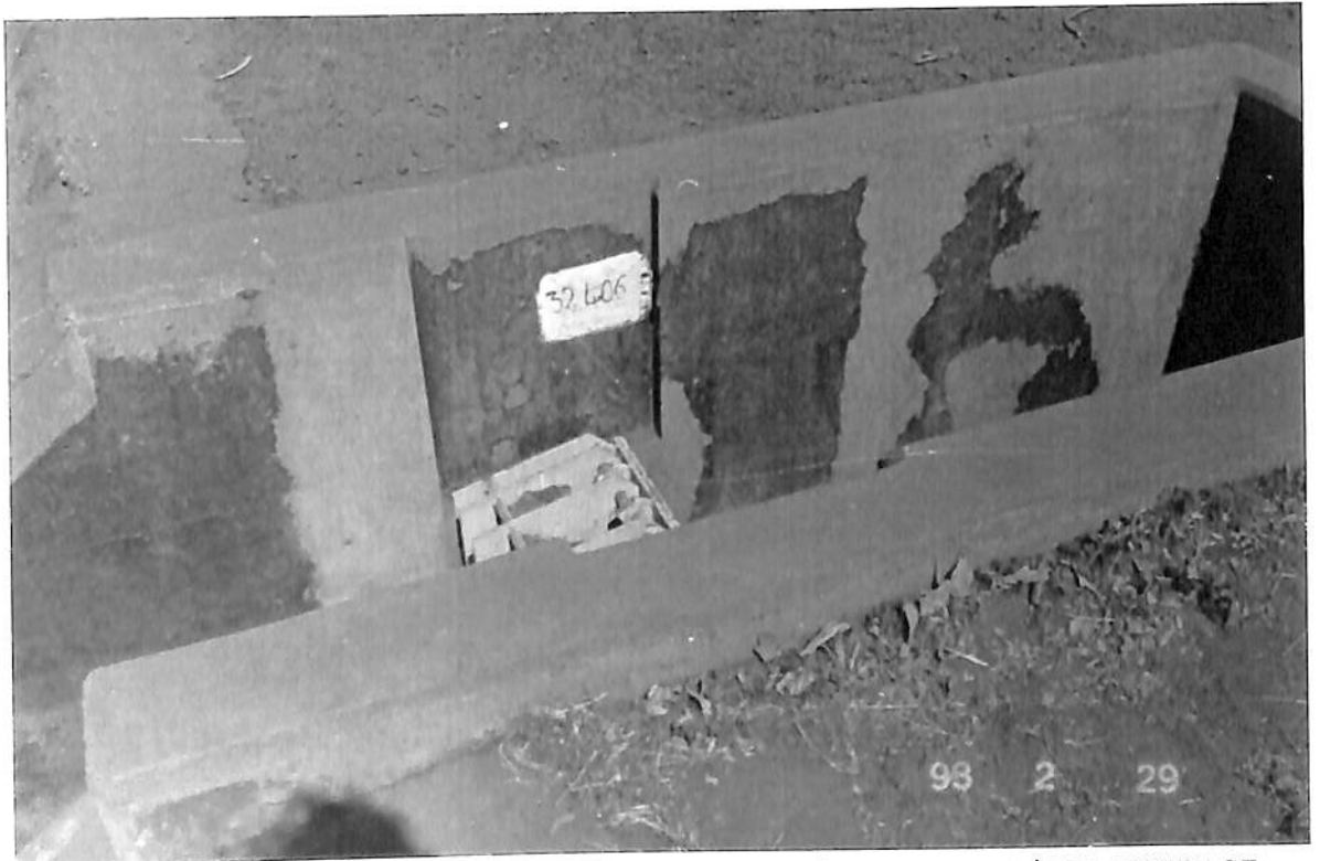
SECONDAIRE A PARTIR DU CANAL PRIMAIRE ; L'ABSENCE D'UN OUVRAGE DE CONTROLE (UN SEUIL) N'EST PAS POUR AMELIORER LE FONCTIONNEMENT HYDRAULIQUE DU MODULE A MASQUE
