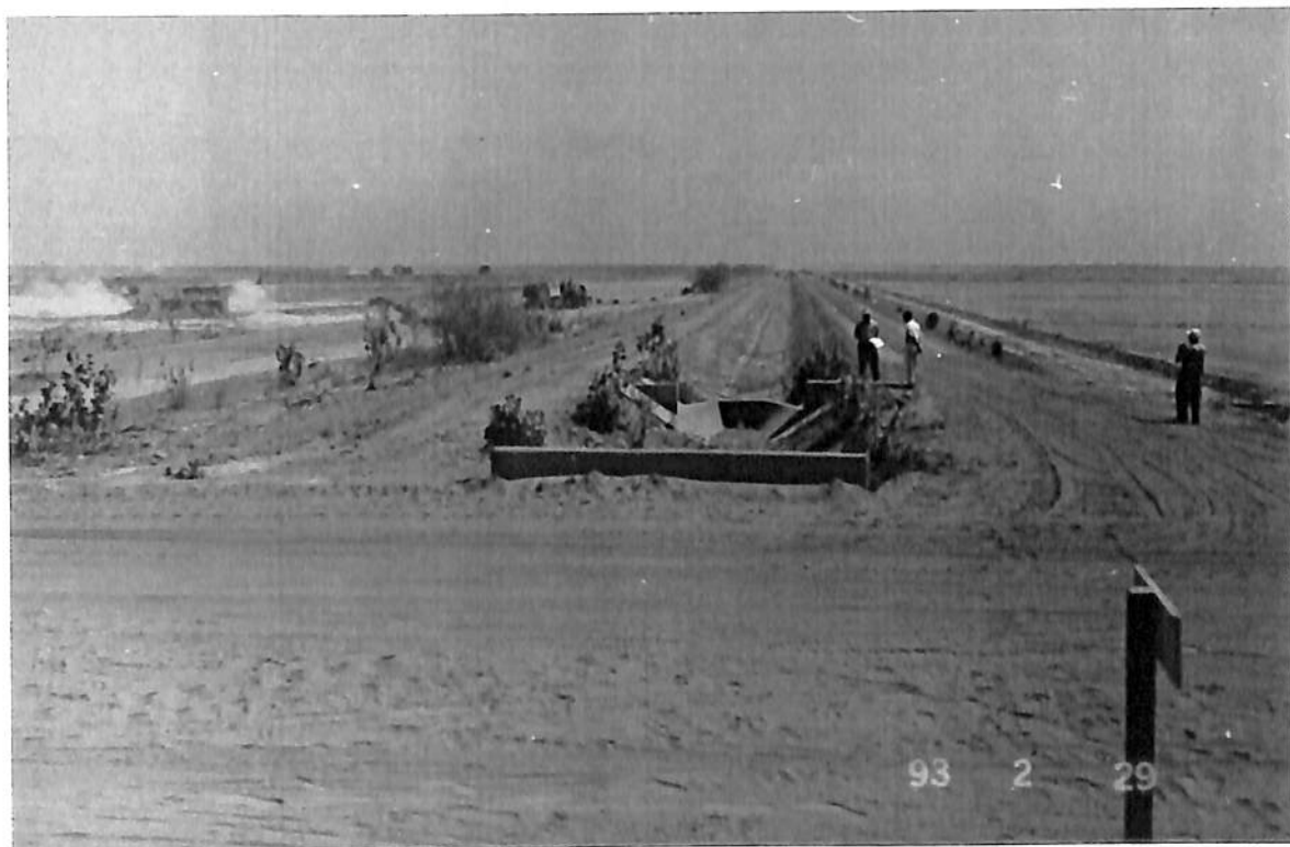
LE DEBIT PRELEVE SUR LE CANAL PRIMAIRE EST ENSUITE ENVOYE SOUS LA PISTE ET REPARTI SUR TROIS CANAUX SECONDAIRES ; LE DESERVOIR "GIRAUDET" FAIT LE REGLAGE DU NIVEAU DU PLAN D'EAU DANS L'OUVRAGE REPARTITEUR ;
