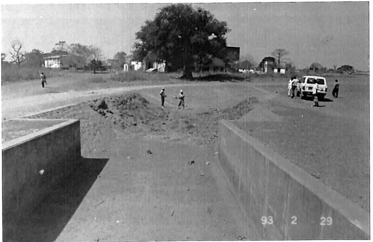
MÊME SORTIE D'EAU, PRISE DE VUE À PARTIR DE LA CONDUITE CHARGÉE, VERS L'AVANT, DANS LE SENS D'ÉCOULEMENT ; NOTONS LA COURBURE ABRUPTÉ AU NIVEAU DU RACCORDEMENT ENTRE PARTIE EN BÉTON ET CANAL EN TERRE (ÉROSION ET ÉBOULEMENTS)
