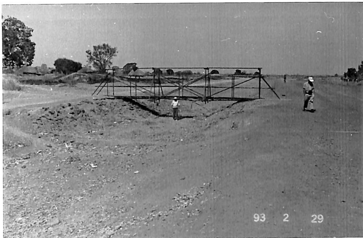
UNE PASSERELLE METALLIQUE DES PIETONS SUR LE CANAL PRIMAIRE (PRES DE LA STATION DE POMPAGE), LE PROFIL EN TRAVERS A ETE SENSIBLEMENT RETRECI A CE NIVEAU, CONDUISANT A LA MISE EN VITESSE DE L'EAU EN DESSOUS DU PONT ; VAUDRAIT MIEUX ELARGIR AU LIEU DE RETRECIR LE PROFIL ;
