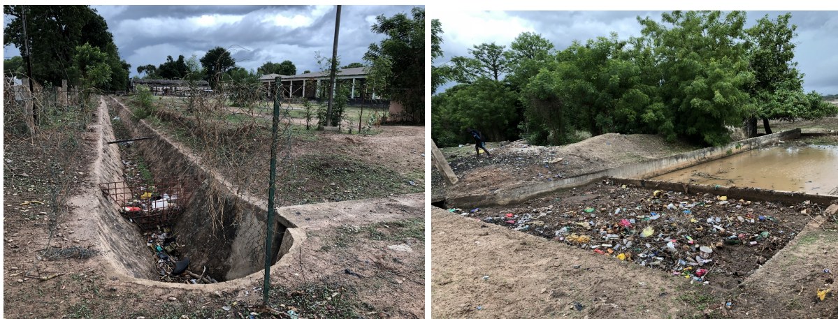
Photo 2-3 : Canal de collecte des eaux de ruissellement (gauche) et bassin de décantation (droite). Clichés : Tropica, juillet 2018
