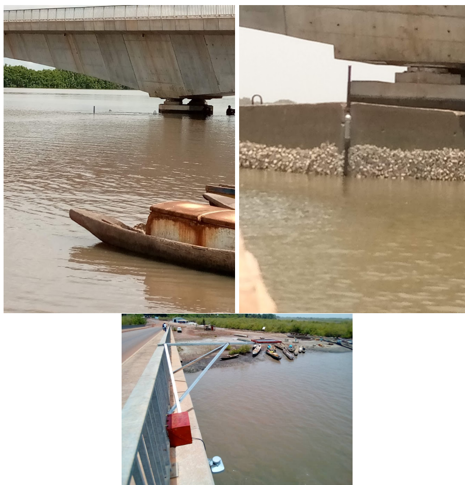
FIGURE 4.9: Première station du pont Sao Vicente qui risquait d'être emportée par les courants (en haut) et la seconde (en bas)
