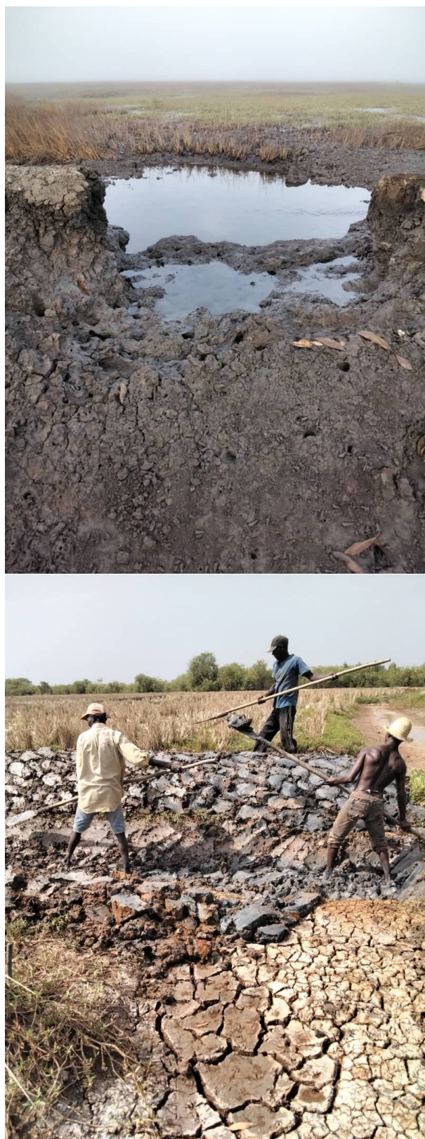
FIGURE 4.14: Rupture de digues après la submersion de digues à Cafine le 10 février 2024
