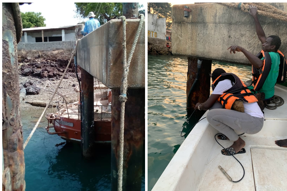
FIGURE 4.4: Station de Boubaque (photo à gauche), l'état de l'installation après collision avec une pirogue (photo à droite)
