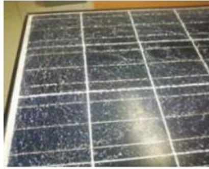
Figure II.4. Module photovoltaïque présentant des bris de verre [15]
