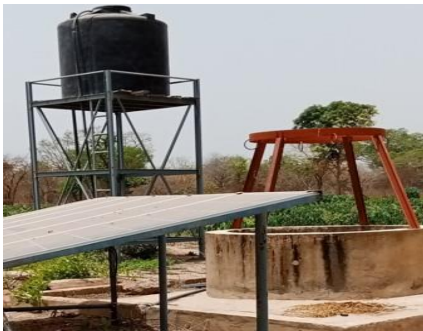
Figure 8: Puits marâcher avec ses équipements (Crédit photo: Sarr, 2023)
