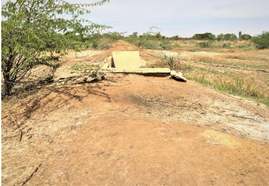
Photo 15 : Digue anti sel endommagée à Sanghaie (Source : cliché SENE, Janvier 2023)
