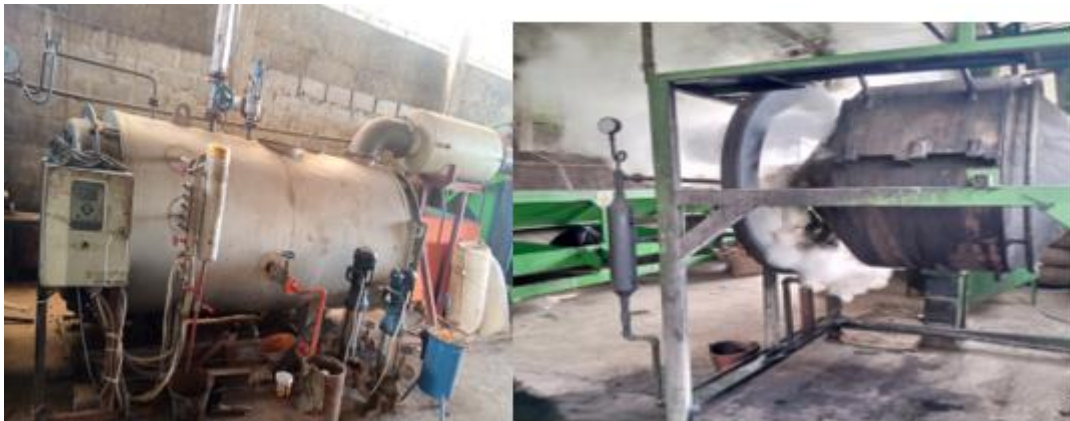
A : La chaudière
