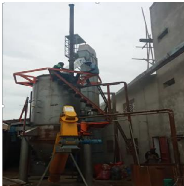
Figure 2.3 : Gazéificateur de la SCPL, SA
