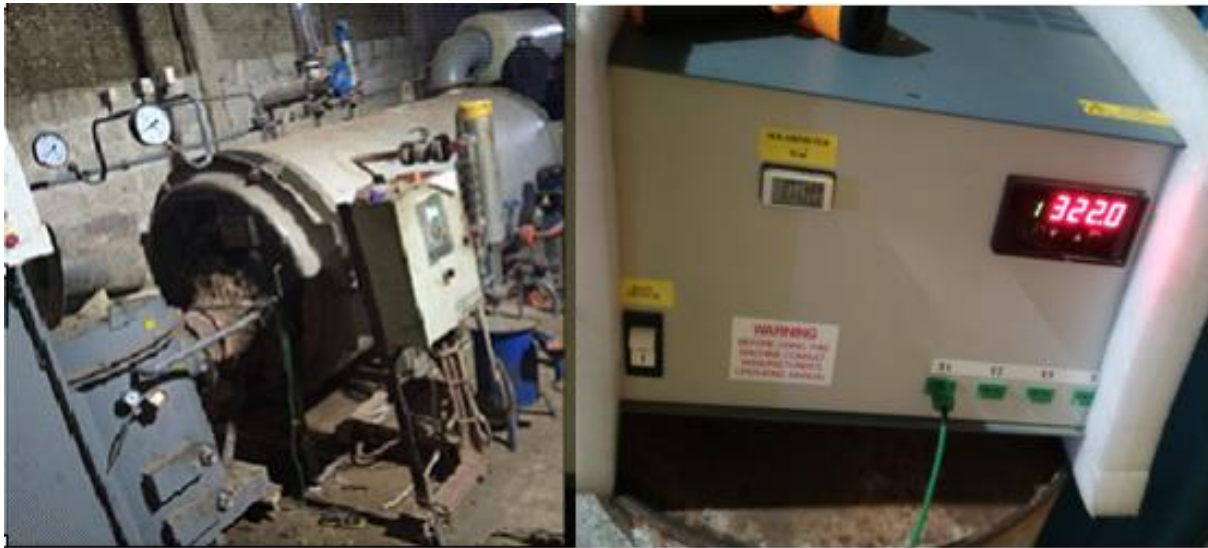
A : Brûleur en fonctionnement de la chaudière
