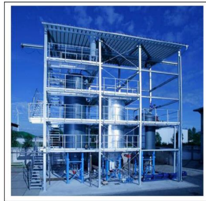
Figure 1.12 : Photo de l'usine HTC à Karlsruhe [28]
