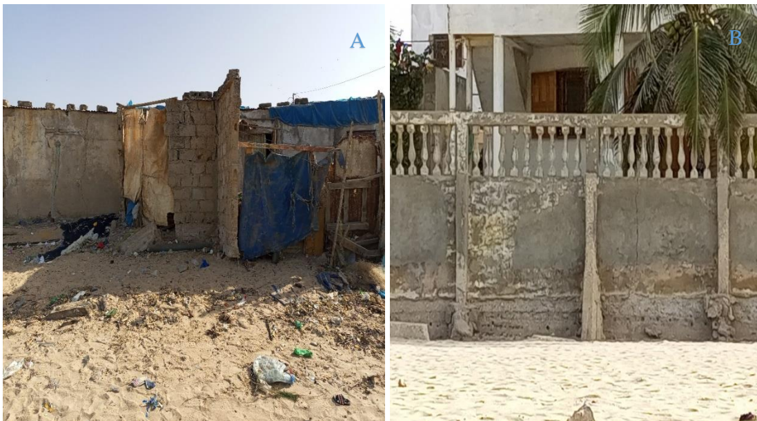
Photo 4: Destruction d'habitats à Golf (A) ; Destruction d'hôtels à Saly Niakh-Niakhal (B). (Source : Yade, Février 2022).
