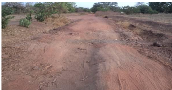
L'état de dégradation très avancée de la route de PATA
