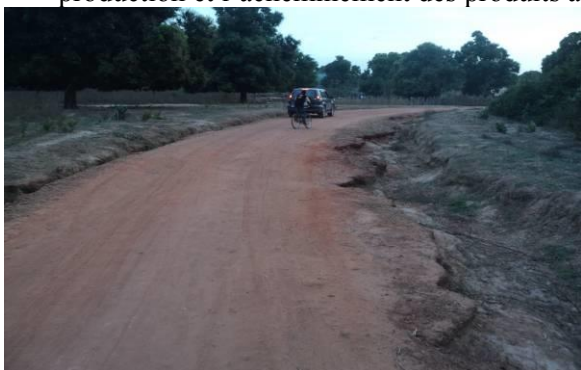
Exemple de piste dégradée vers les villages de DIEBA et de SINDIALONG
