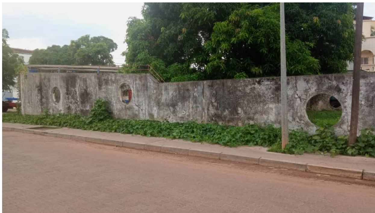
Photo 88 : Friche d'habitation, Boudody-Escale (AMERDINE, 2020)
