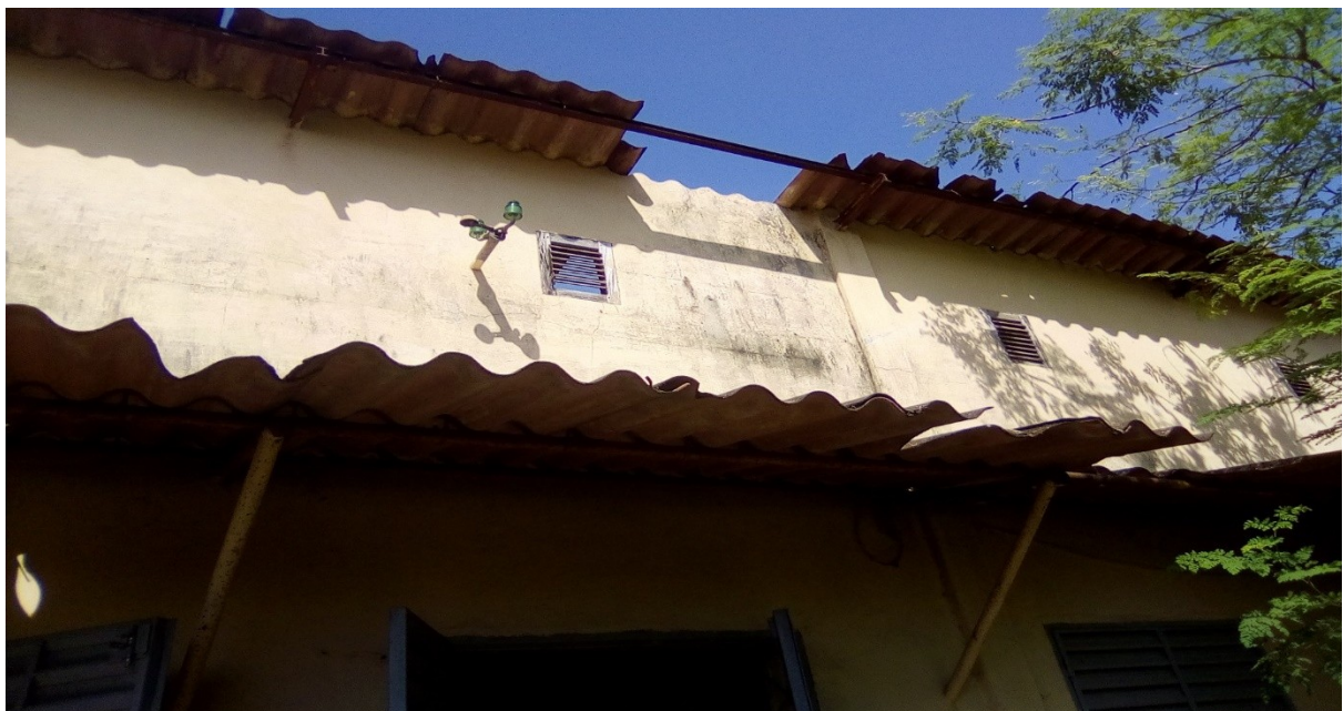
Photographie 2 : délabrement de la toiture du PS PMI-Escale (source : Tamba, février 2019)
