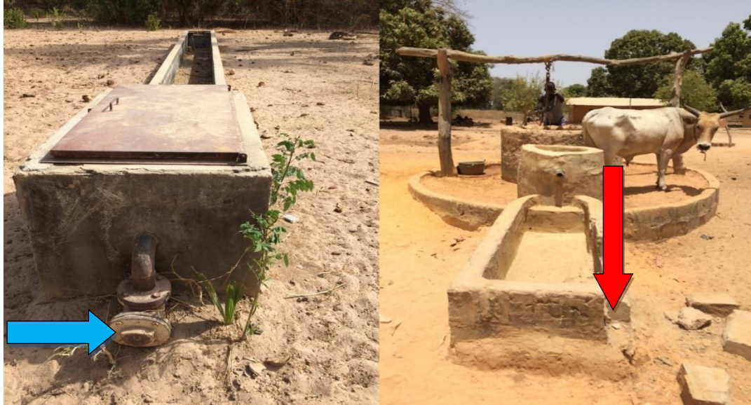
Photo 4: Moyens d'accès à l'eau pour le bétail (en dégradation dans la zone Baila Djibidione) (Clichés, Sadio C.A.A.S., 2017)
