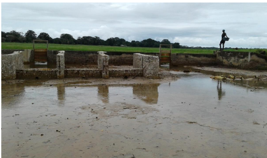
Photo 5: Rôle des aménagements hydroagricoles dans la vallée du marigot de Baila : le barrage de Karthiack (Clichés, Sadio C.A.A.S., 2017)
