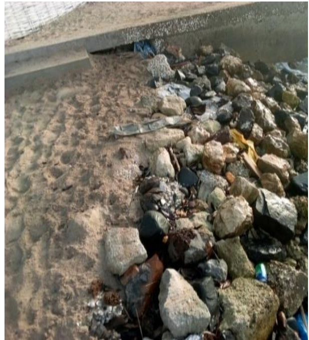
Photo 14 : Diguettes de protection contre l'érosion à Carabane (source : MANGA 2018)
