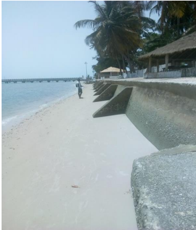
Photo19 : mur de protection contre l'érosion à Carabane (Source : MANGA2018)
