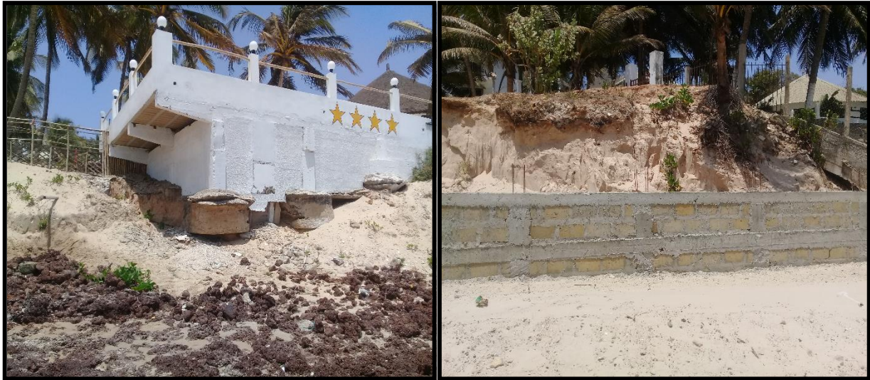
Image 11 : Deuxième mur de protection de l'hôtel Hibiscus (à gauche) et érosion du restaurant Hibiscus (à droite) Diatta, 2019.
