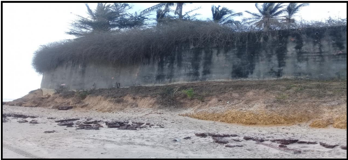
Image 14 : Mur de protection de l'hôtel Jet Tours (Source : Diatta, 2019).
