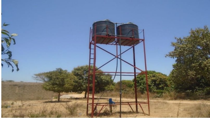
Photo16 : système d'approvisionnement en eau à Hilol (Barry, Avril 2016)
