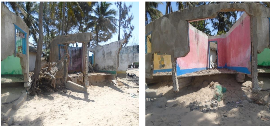
Photos 9 : Campement la Nature détruit par l'érosion côtière à Kafountine (Barry, Mars 2016)
