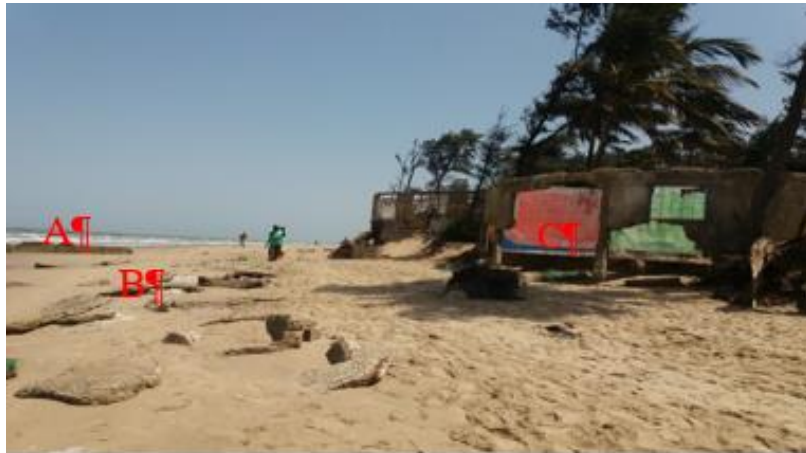
Photo11 : Destruction de l'hôtel La Nature par les vagues à Kafountine : destruction des installations en épi (A) et du mur de protection (B)
