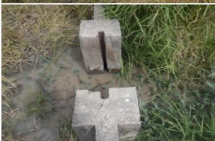
Photo (4b) : Sur cette image l'absence de vanne de protection est à l'origine de l'assèchement des parcelles
